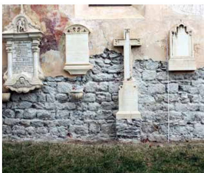
Nach Abnahme des schadhafte Sockelputzes kam an der Südfassade des Langhauses der romanische Kernbau zum Vorschein
