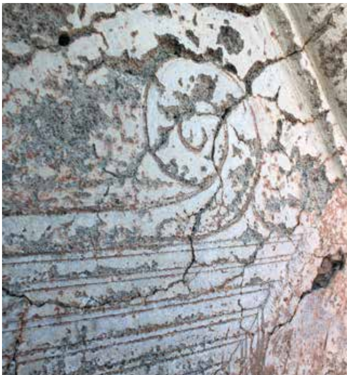
Putzschäden am Sgraffitodekor der Westfassade vor der Restaurierung
